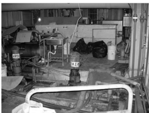
圖 7.3.4-3 管線未加標示現場凌亂
