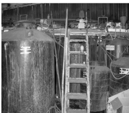
圖 7.3.4-1 設備老舊現場凌亂
