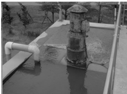
圖 7.3.5-2 廢水處理設施容量不足
