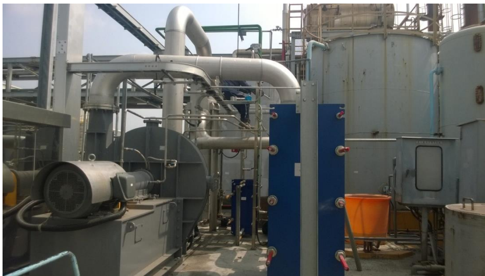
圖 9 MVR 廢水回收系統-2
