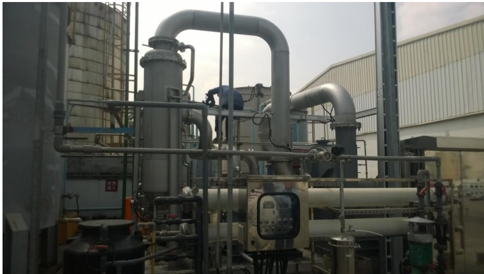
圖 8 MVR 廢水回收系統-1
