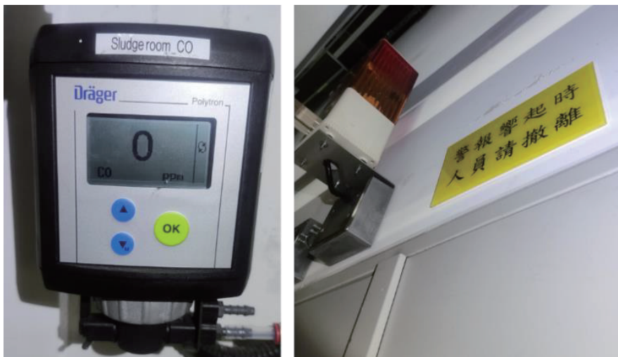
圖 12 設置 CO 氣體偵測器及指示燈和蜂鳴器
