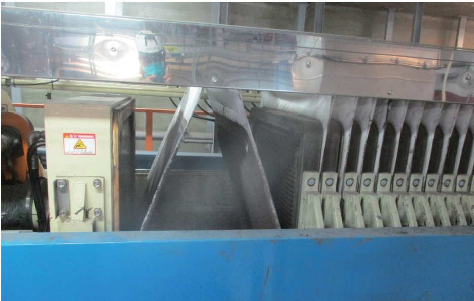
圖 4 無機污泥脫水機冒煙
