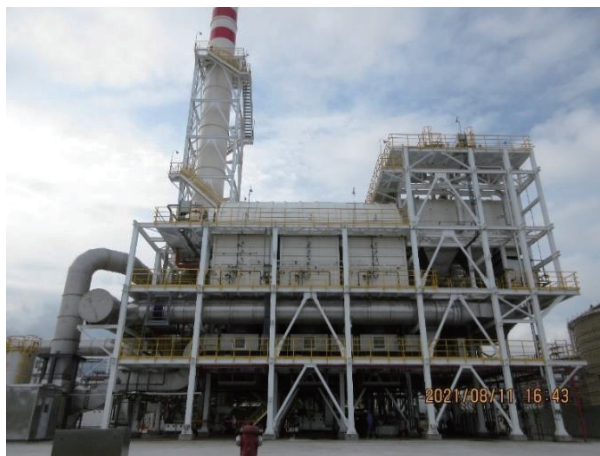
圖 11 PDR-RTO 鍋爐 (照片由奧特拉斯公司提供, 2021)
